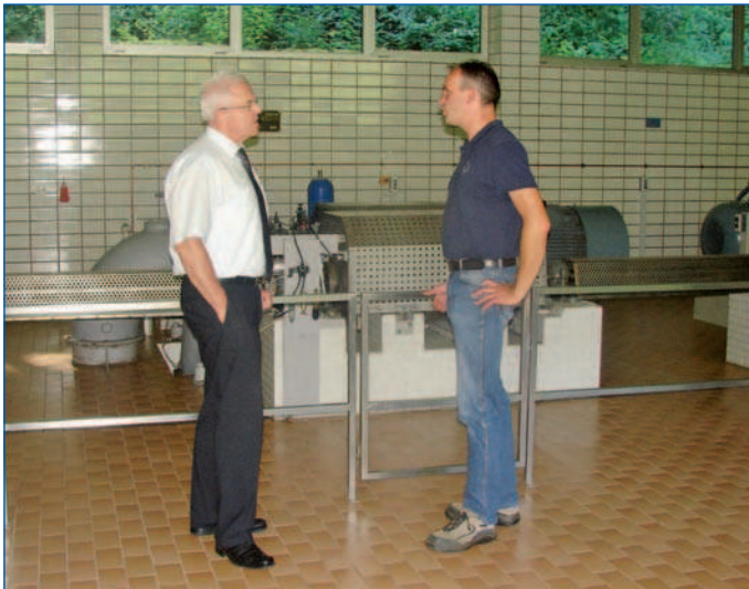
Im Wasserwerk Eybtal können bis zu 100kw in der Stunde an Strom produziert werden.
