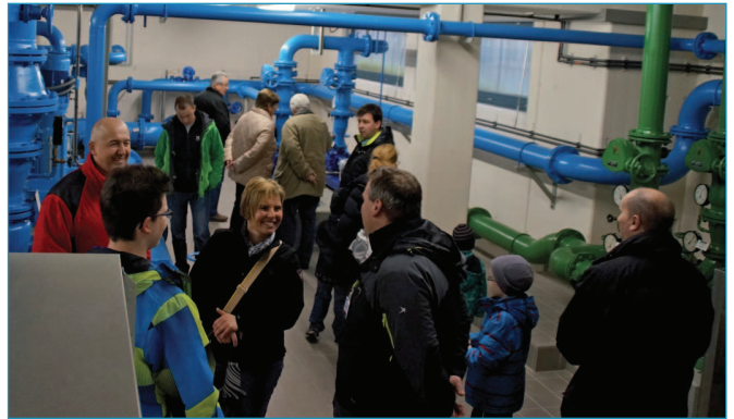
Der Rohrkeller im modernen Wasserwerk.
